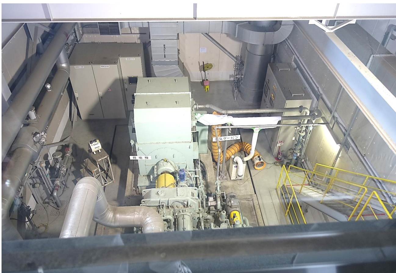
ごみを燃やしたエネルギーを利用した発電装置 (エコクリーン松江で利用する電力をまかない、余りは中国電力へ販売しています)
